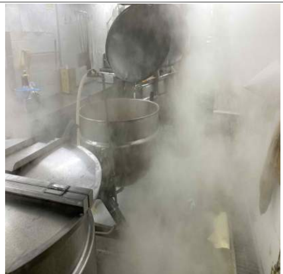
그림 44 학생회관 조리작업 시 환기 상황2
