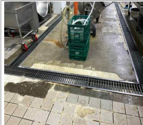
그림 64 타일이 깨진 조리실 바닥
