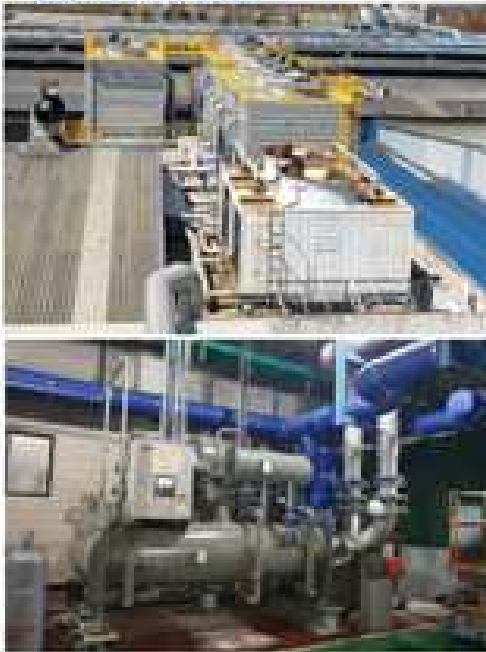
<1공장 신설 냉동기, 냉각탑>
