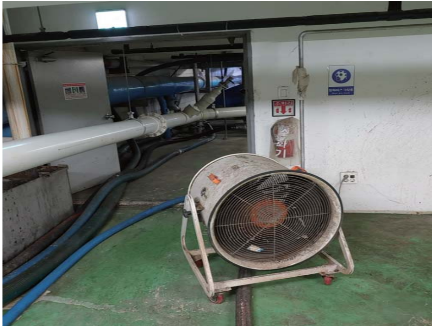
<그림5> 중층 내에 설치된 공업용 송풍기
