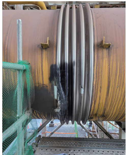
▲ 고인이 숨지기 전 작업하던 장소. 육안으로도 확인할 정도로 가스 배관의 균열이 심하다. 사진 : 현대제철당진공장 중대재해비상대책위원회
