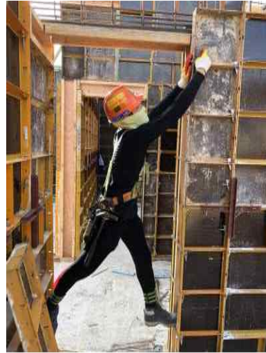
그림 48 발판을 사용하지 못할 때 불안정한 작업
