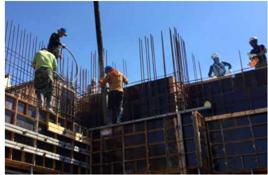
그림 76 안전수칙이 지켜지지 않는 타설 작업
