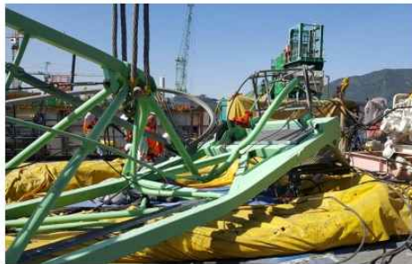
노동부가 작년 5월 1일 발생한 경남 거제 삼성중공업 타워크레인 붕괴사고 현장. 이 사고로 비정규직 노동자 6명이 숨지고 25명이 크게 다쳤다. 경남소방본부 제공
