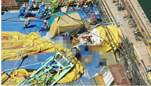
지난해 5월 삼성중공업 거제조선소에서 타워크레인 붕괴 부분이 작업장을 덮친 모습. 현장에 있던 근로자 4명(모자이크 처리)이 쓰러져 있다. 한국일보 독자 제공
