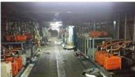
지하에 위치한 형광램프생산라인 내부
