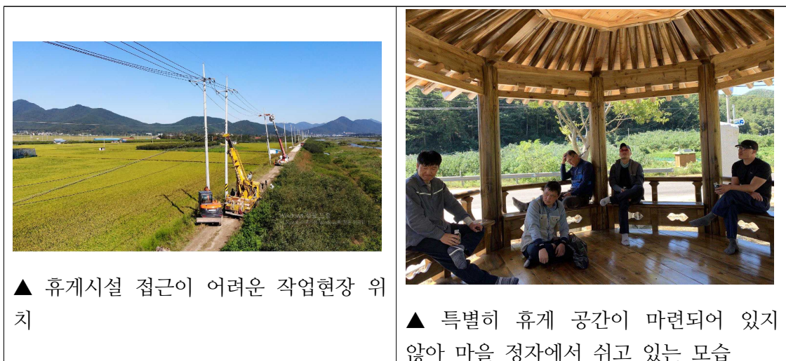
그림 19 휴게시설 접근이 어려운 작업현장
